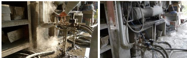
蒸気漏れ 対策前
