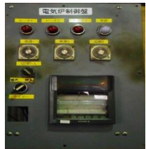
電気炉の制御盤
